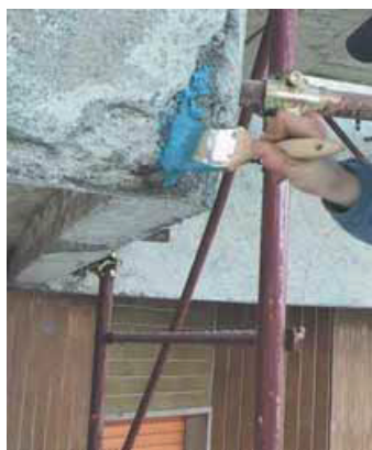
Aplicación a brocha de Mapefer 1K sobre los hierros de la armadura en un balcón de concreto armado
